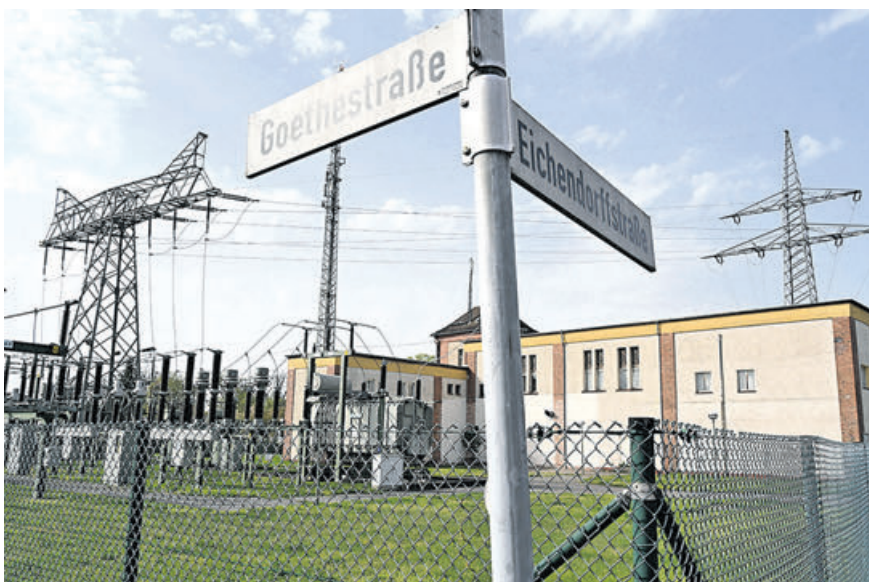
Ein neues Umspannwerk ist nötig, um die Oranienburgerinnen und Oranienburger auch künftig sicher mit Strom versorgen zu können. Das aktuell genutzte Umspannwerk in der Germendorfer Allee wird von Edis betrieben.
