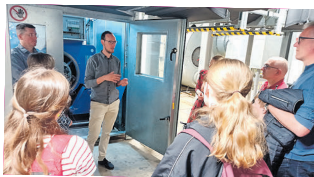
Wie funktioniert eigentlich ein Blockheizkraftwerk? Bei einer Führung durch das Heizkraftwerk der Stadtwerke erhielten die Teilnehmerinnen und Teilnehmer einen spannenden Einblick in die Energie- und Wärmegewinnung.
